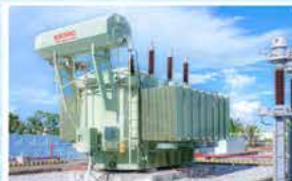
Máy biến áp truyền tải 110 - 220 kV
