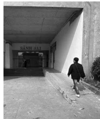
Đường dốc thiếu tay vịn, không đảm bảo an toàn
